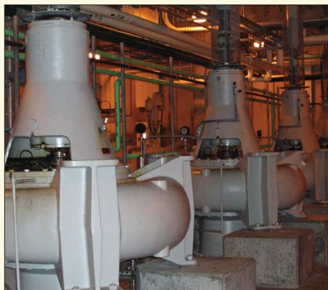
Bombas de efluentes, vedadas com selos bipartidos com diâmetro de 200 mm (8,00 polegadas), estão em funcionamento há mais de 12 anos.
