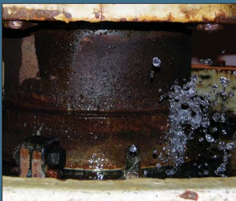
Vazamentos levam à corrosão no equipamento e falha prematura nos rolamentos
